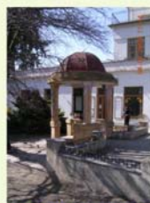
Stav altánku před opravou
