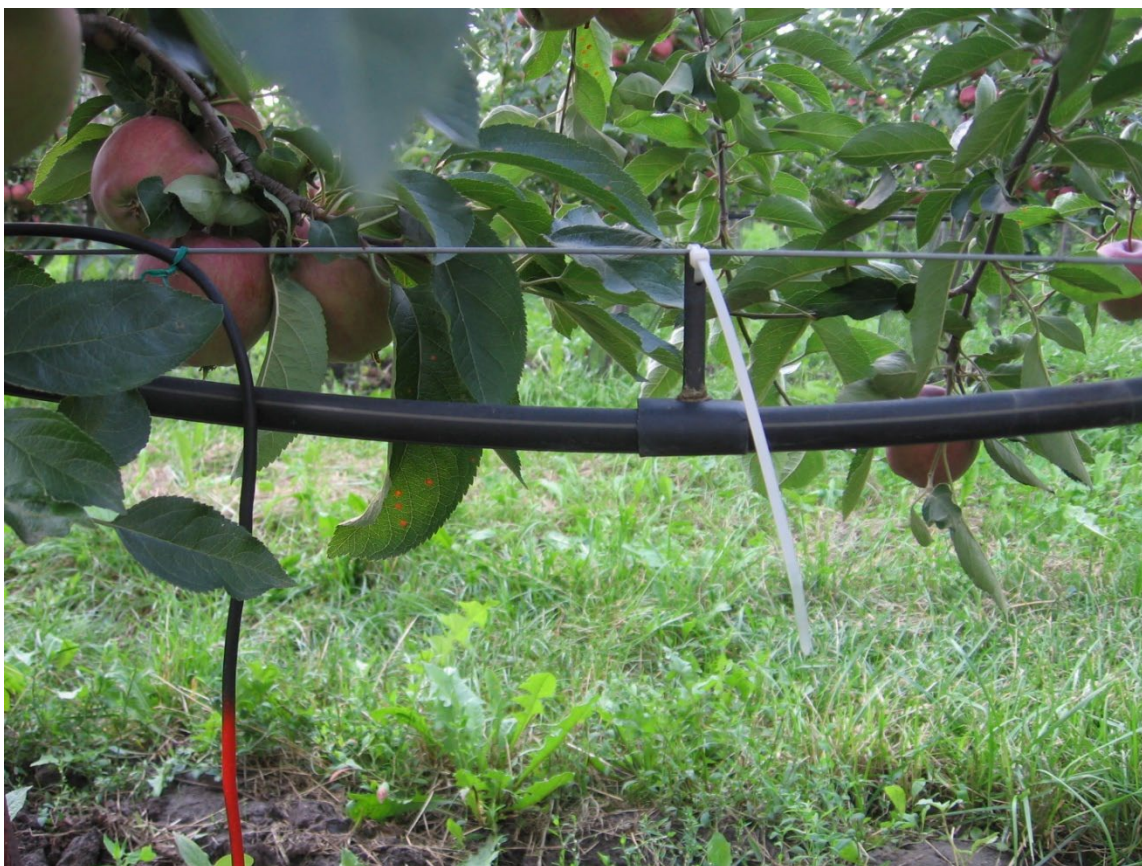
Obr. 3 Prohnutí kapkovací hadice pomocí rozpěrky v místě nad snímači půdní vlhkosti umístěnými v řadách
