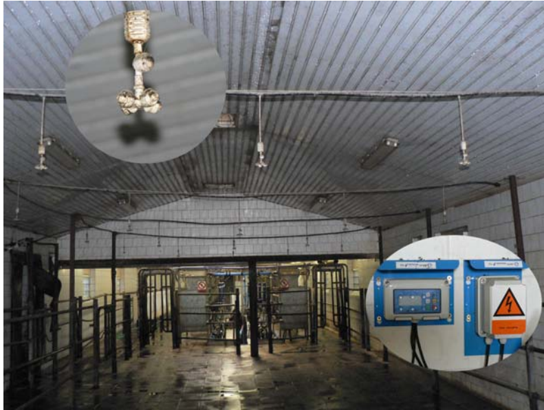
Ukázka instalace systému v prostředí dojírny
